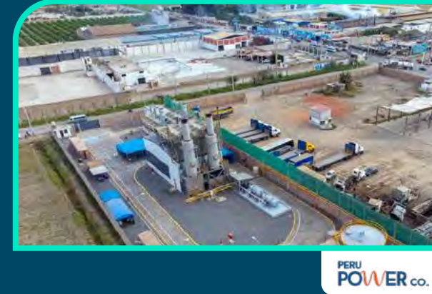
CT Pedregal: 18.6 MW
